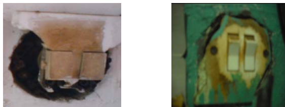
Gambar 7. Saklar Tidak Standar
