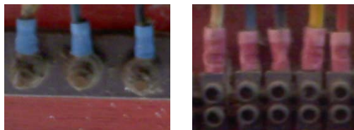
Gambar 12. Sambungan Kabel dengan Sepatu Kabel
